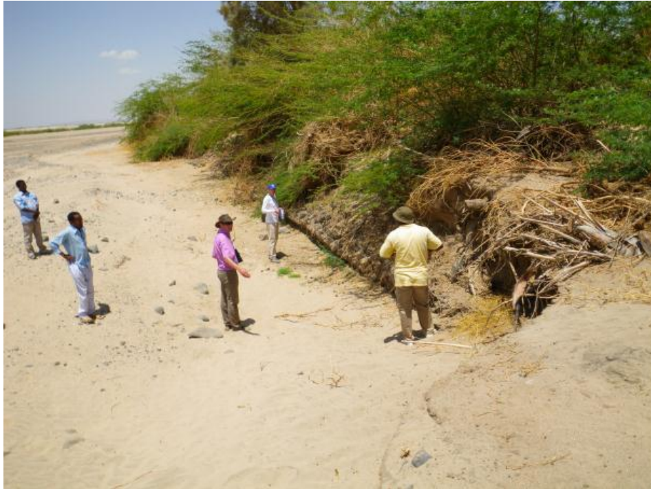
Photographie 11 : Gabions endommagés. D'après les témoignages, les gabions ont été construits après un décaissement de 50 cm alors qu'il apparaît très nettement qu'il est aujourd'hui surélevé.
