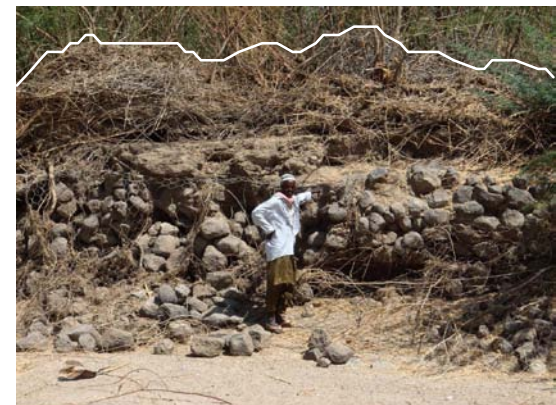
Destruction d'un gabion avec indication des laisses de crue (trait blanc)
