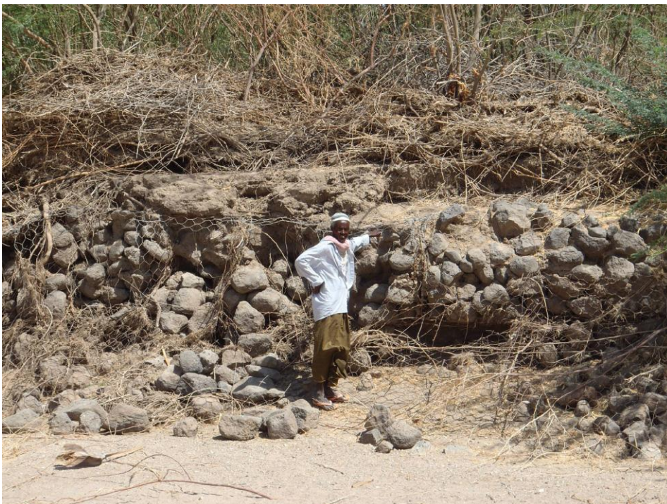
Photographie 12 : Gabion endommagé. Les laisses de crue et le dépôts alluviaux montrent qu'il a été largement submergé.
