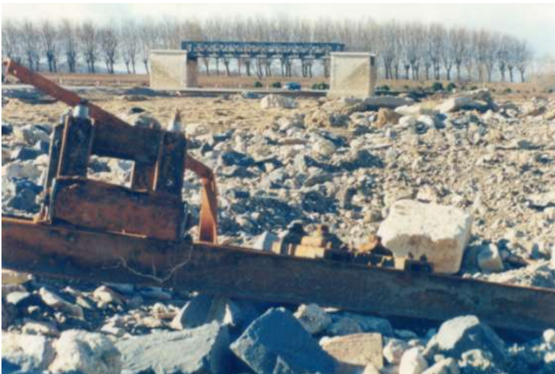
Le remblai et les rails ont été emportés par les eaux de part et d'autre des culées. Au premier plan, gisent les débris du ballast. (Cliché : M. Bonavida)
