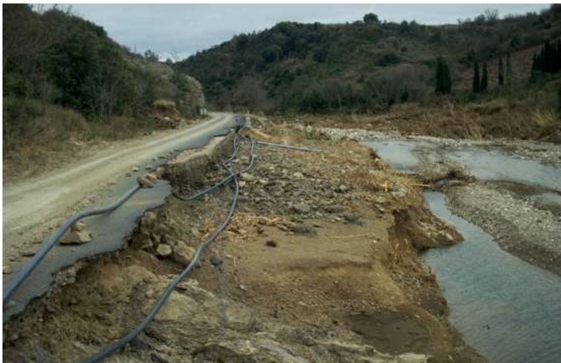
Photographie 4 : route coupée par la crue de la Berre à l'amont de Durban-Corbières.
