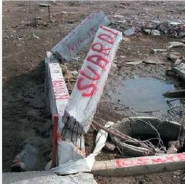
Figure E5 : Effets d'arrachement des poteaux de faible largeur. Banda Aceh (Leone et al, 2007).
