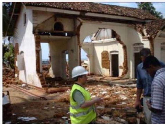
Figure E4 : Exemple de dommage aux murs en briques parallèles au trait de côte. Tsunami 26 décembre 2007, Sri Lanka (EEFIT, 2005).
